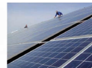
Système de panneaux photovoltaïques
