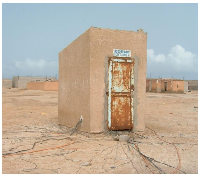
Figure 14 : Connexions pirates au réseau électrique
