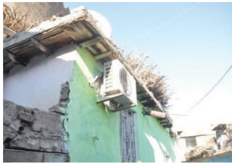
Climatisation d'une maison
