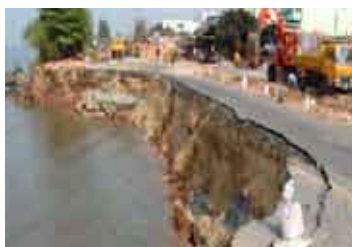
Sạt lở tại QL91-Châu Thành, An Giang - tháng 3.2010
