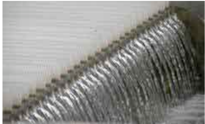
Système lamellaire de traitement de l'eau - Usine DOWACO
