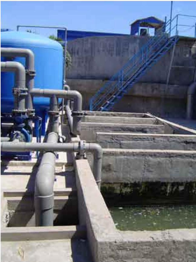
Traitement des eaux usées à Vinh Hoa Corporation
