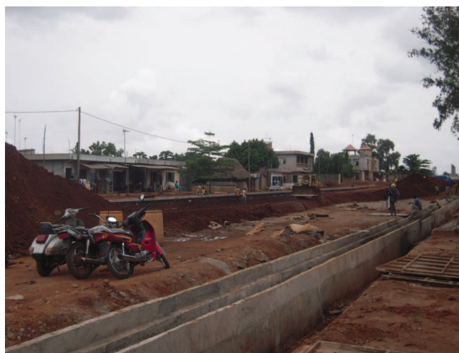
Pose de bitume sur la rocade au niveau de la Piscine municipale Laying asphalt on the bypass at the Municipal Pool
