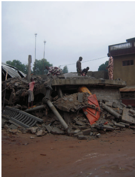
Une maison effondrée après la pluie du Dimanche 20 Juin 2010, à Koutongbé - A house collapsed after the rain Sunday, June 20, 2010, in Koutongbé
