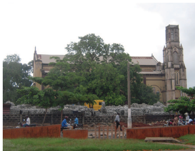
Mise en place de trottoirs pavés pour la rue devant la cathédrale Establishment of paved sidewalks on the street in front of the cathedral
