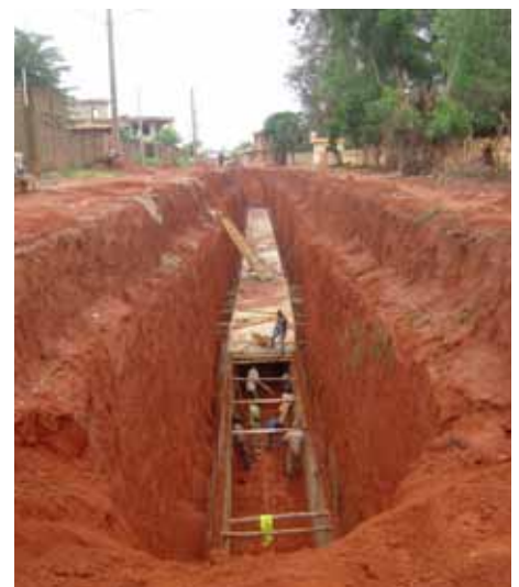
collecteur G - The construction of a drainage network to Anavié: manifold G
