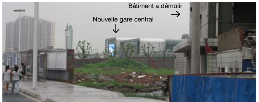
Autour de la gare plusieurs bâtiments sont démolis afin de créer du foncier disponible pour de nouveaux bâtiments.
