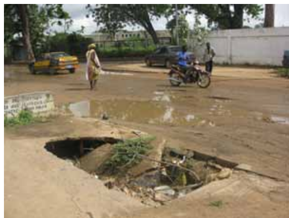
Canalisations cassées et remplies d'immondices
