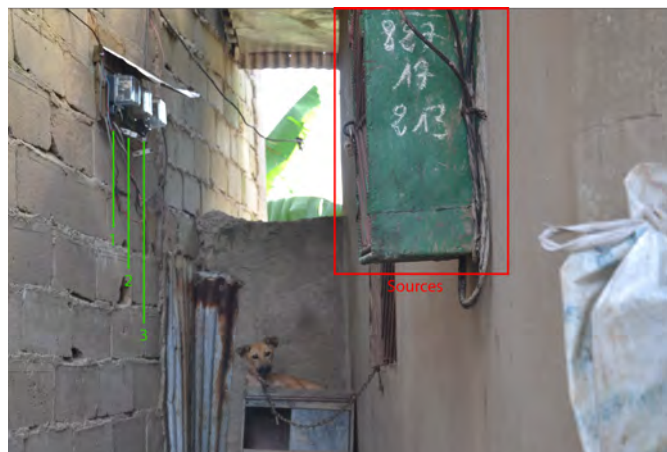
Branchement informel dans le quartier Malangue : source et trois branchements
