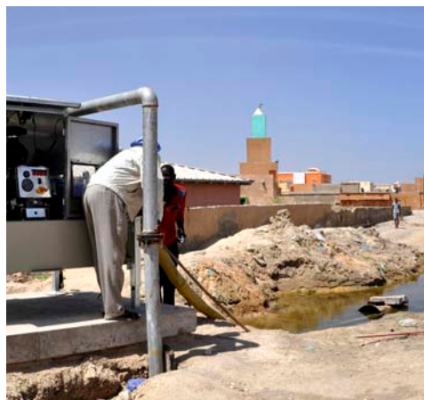
■ Systèmes de pompage pour libérer la ville de l'eau stagnante à Socogim PS, suite aux inondations de 2013
