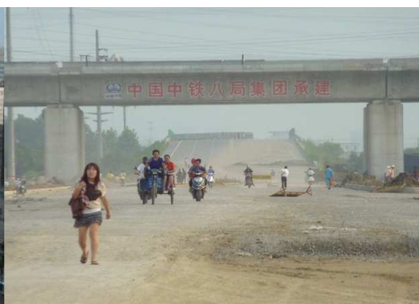
Autoroute en construction sous le viaduc de la nouvelle ligne TGV Pékin-Shanghai
