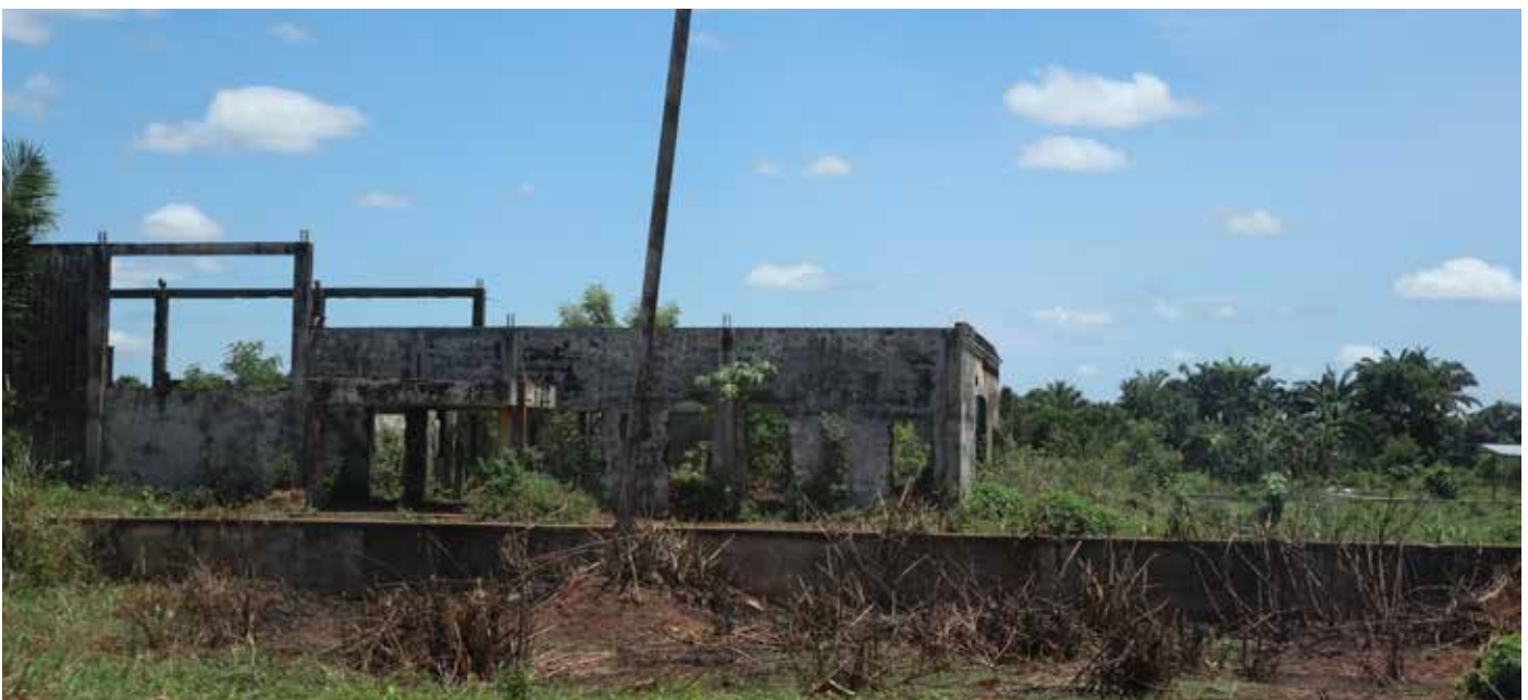
Usine détruite dans le quartier Kolongo
