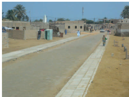
Pikine : création d'une nouvelle voie intégrant un réseau de récupération des eaux pluviales.
