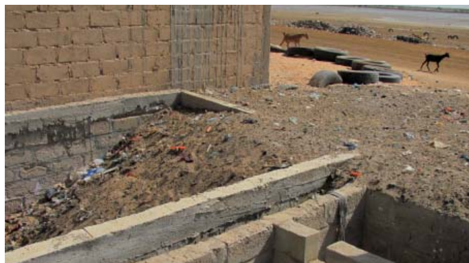
Fondations remblayées avec les déchets - Pikine.
